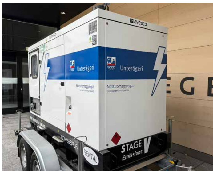
Das neue Notstromaggregat steht für den Notfall bereit
